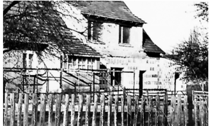
Der Ausbau des Früheren Stalles ist im Rohbau fertig. Wohnhäuschen einer Familie 1981.
